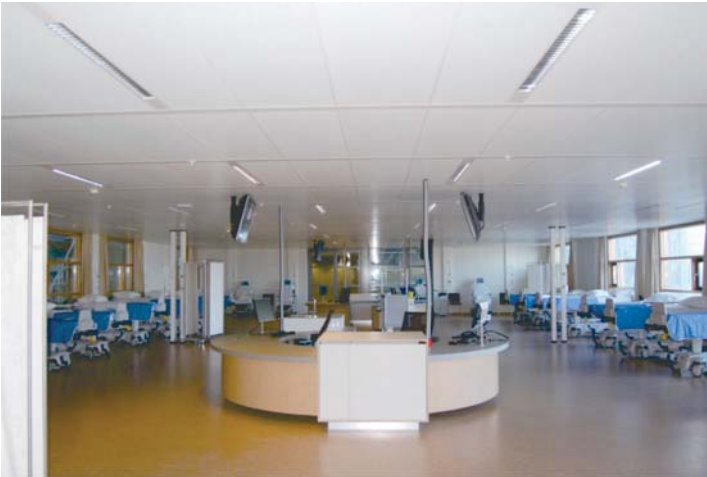
荷兰马斯兰医院-冷辐射吊顶
