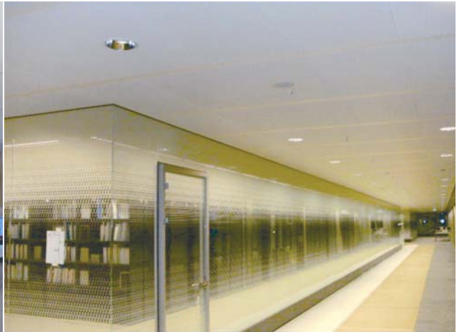
荷兰海牙财政中心-冷辐射吊顶
